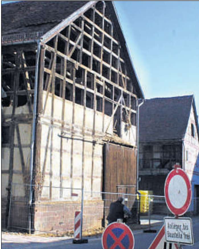
Morgen schon Vergangenheit: Bereits Donnerstag wird von der Scheune nur noch Bauschutt zu sehen sein.
