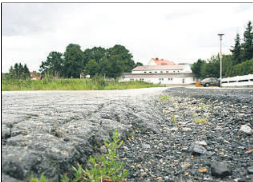
Jämmerlicher Zustand: Die Schulstraße in Westuffeln ist schon seit vielen Jahren ein Flickwerk. Demnächst soll gebaut werden.
