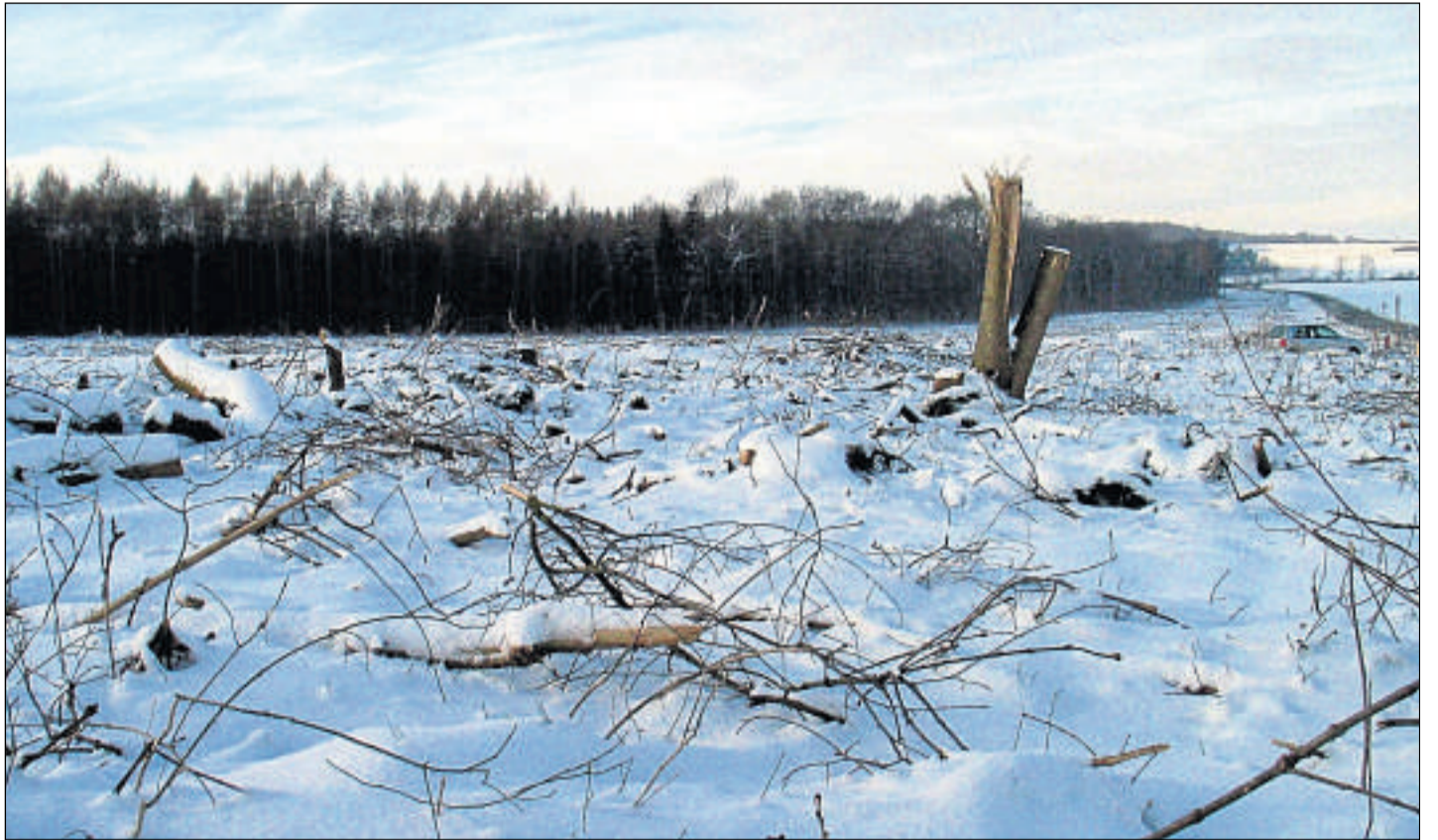
Ein ganzer Wald ist verschwunden: Zwischen Calden und Westuffeln wurde der Baumbestand entlang der Bundesstraße 7 erheblich dezimiert. Die Arbeiten bereiten den Weg für den Ausbau des Flughafens.
