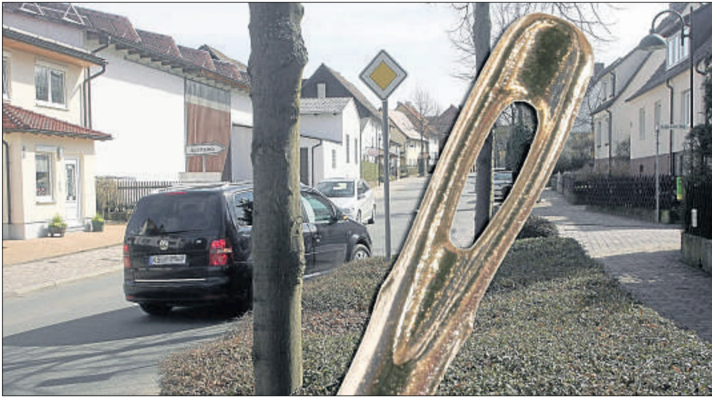
Nadelöhr Weimarer Straße: Selbst nach Absägen der Bäume wird es knapp, neben der Baugrube noch Platz für eine Pkw-Fahrspur sowie einen vorrangigen Gehweg zu schaffen. Heute gibt es vor Ort ein Expertentreffen, um alle Möglichkeiten zu prüfen. Fotos: Thiele
